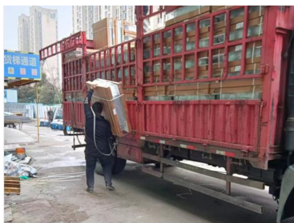
(空调设备到场)
